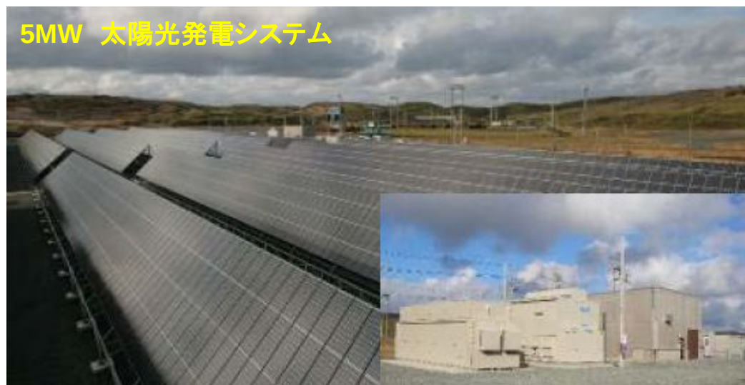
北海道稚内太陽光発電所 NaS電池:10.8MWh
